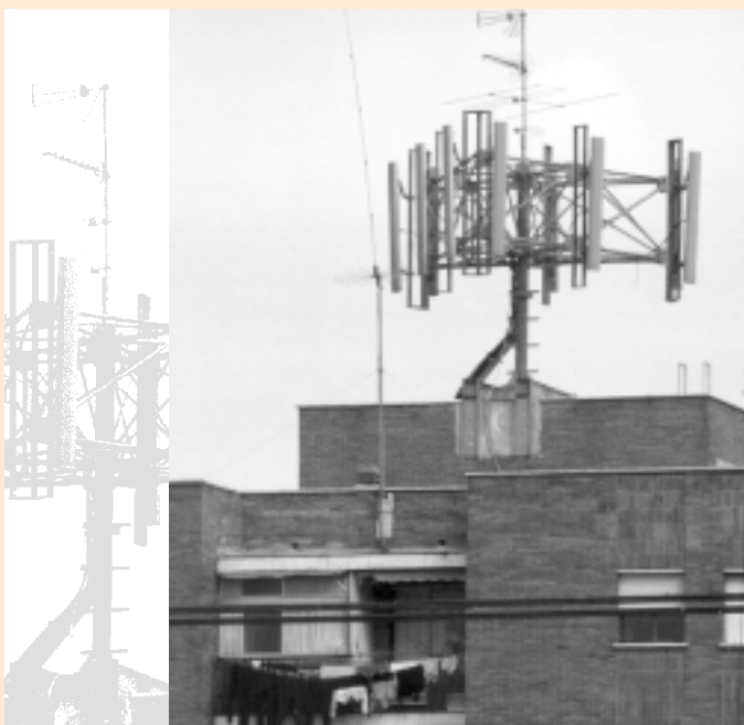
Antena en la parte superior de un edificio de viviendas.
